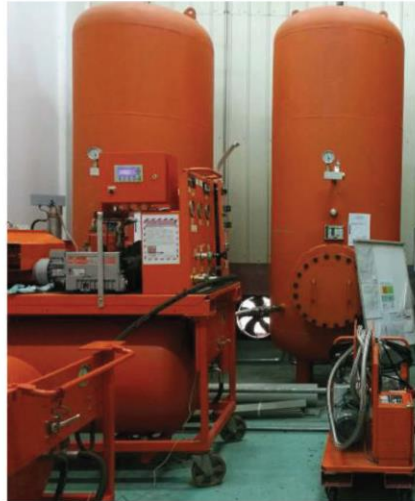
上图照片所示 2015 年 GE & ALSTOM SHV 气站主站房设备
