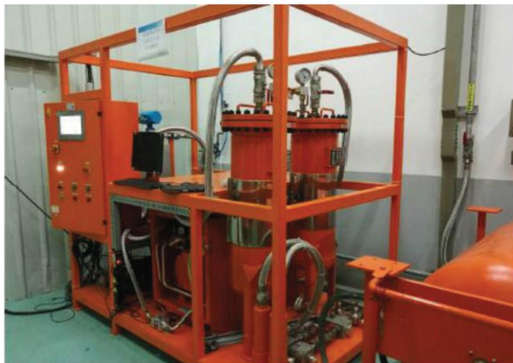
上图照片为气站系统主站机
